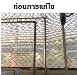
ภาพที่ 5 ท่อลมและท่อลำเลียงก่อนการแก้ไข
