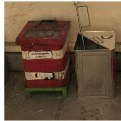
ภาพที่ 9 กังพักท่อดูด ก่อนการแก้ไข
